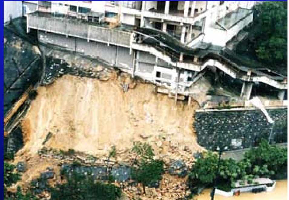
1994 觀龍樓山泥傾瀉 (污水渠滲漏)
